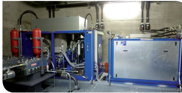
Drei Flüsteraggregate mit insgesamt vier Antriebspumpen
