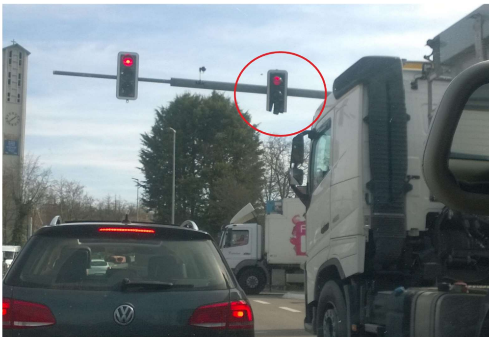
Abbildung 2: Beispiel einer defekten Signalanlage (KIT FAST)
